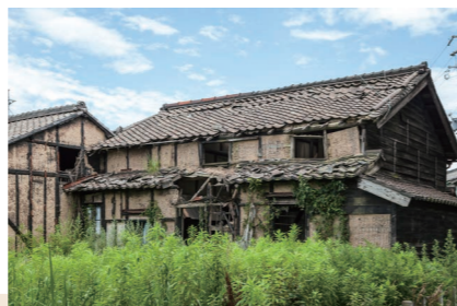
空き家が放置されると外壁や屋根の崩落、雑草の繁茂などが起こり、通行人に危害を及ぼしたり、蚊やネズミなどの発生による衛生環境の悪化を招く
