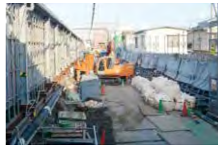
地下化による連続立体交差事業が進行する西武新宿線（沼袋駅付近）
