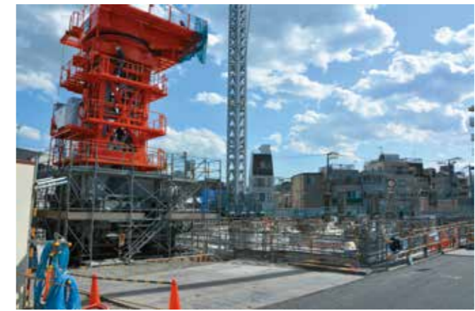
都道と都電荒川線沿いで行われている東池袋五丁目地区第一種市街地再開発事業
