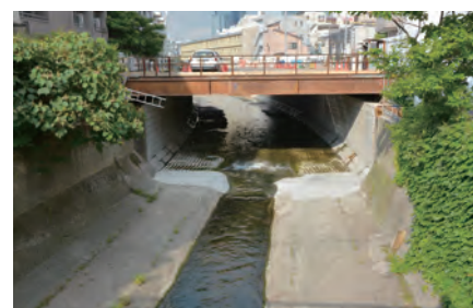
河道工事が進む神田川（東京メトロ中野富士見町駅付近）。手前は拡幅前、奥は拡幅後。河道を拡げて流量を増やす
