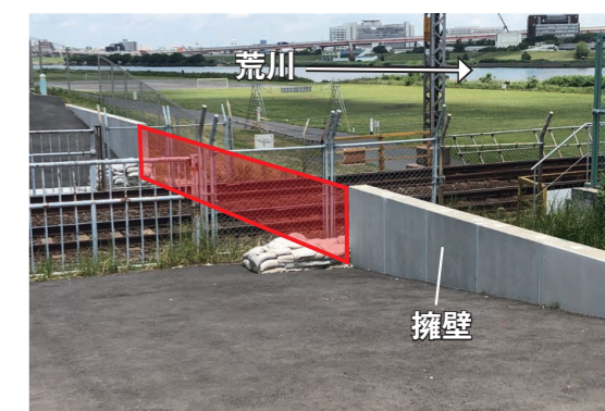
水があふれるのを防ぐための擁壁。堤防の高さに合わせている。河川敷が沈むような水害時には、線路上の□部分に土嚢を積む
