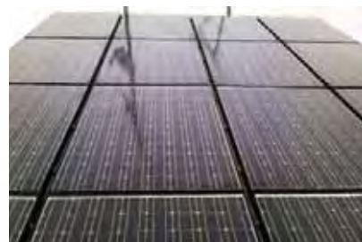
屋上に太陽発電装置を設置(写真右のブルーの部分)。CO 2 の年間削減量約1,000kgを実現。太陽電池モジュール190W 4直列×16＝3.04KWの能力
